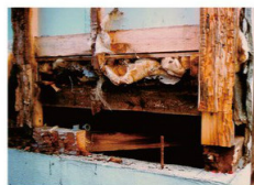
内部結露により躯体が腐朽 「住宅省エネ技術 施工技術者講習テキスト」より
