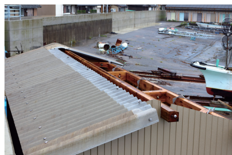
屋根葺き材が飛散した事例
